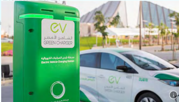
DEWA EV充電設備 (出典：UAE国営通信)
